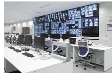
大手町プレイス内防災センター
