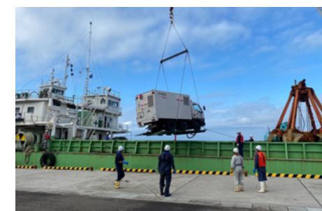
台風9号被災時の電源救済オペレーションの様子
