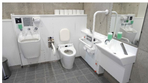
車いす利用者用トイレ
