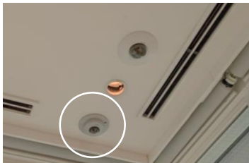
2階ネクスタワーカーズラウンジ (手前は防犯カメラ)
